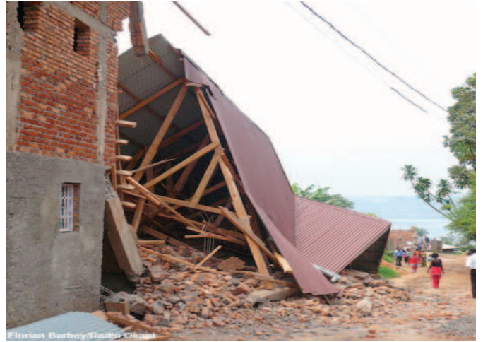
Photo n°2 : Maison effondrée par un tremblement de terre
